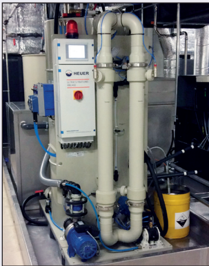
Mikrofiltrationsanlage mit Inline Modulreinigung und Touch Screen Display
